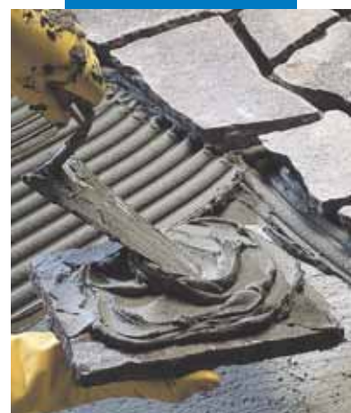
Τοποθέτηση κομματιών πελεκητής πέτρας με ή χωρίς άπλωμα κόλλας και στην πλάτη του πλακιδίου ανάλογα με το πάχος εφαρμογής
