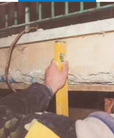
Αποκατάσταση της προστινής όψης της πλάκας σκυροδέματος ενός μπαλκονιού: τοποθέτηση ξύλινου καλουπιού
