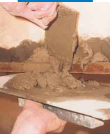
Αποκατάσταση της προστινής όψης της πλάκας σκυροδέματος ενός μπαλκονιού: εφαρμογή του Planitop 400
